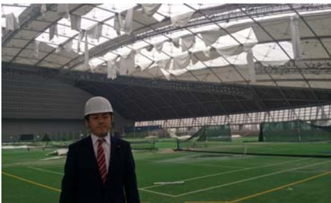
3月5日(水) @くまがやドーム(熊谷市) 大雪により崩落した天井の被害状況を視察
